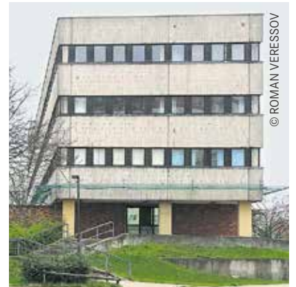
Polizeigebäude in der Pablo-Picasso-Straße: Nur durch ein grünes Netz sind PolizistInnen und BürgerInnen vor dem abfallenden Fassadenputz geschützt.
