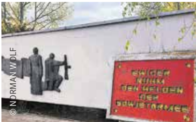
Sanierungsbedürftig: das Denkmal in der Küstriner Straße.
